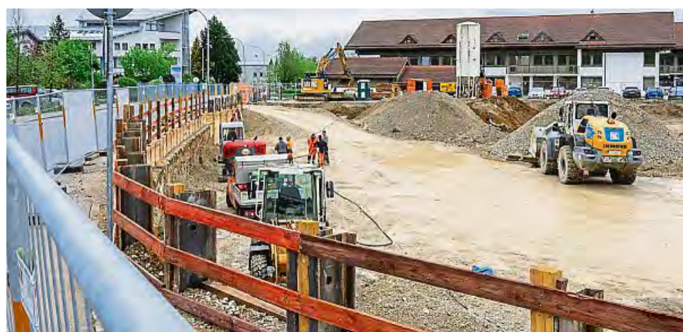
Auf Hochtouren laufen die Erdbauarbeiten für den Gebäudekomplex, der unter anderem 109 Wohnungen umfassen wird. FOTO: THOMAS PLETTENBERG
